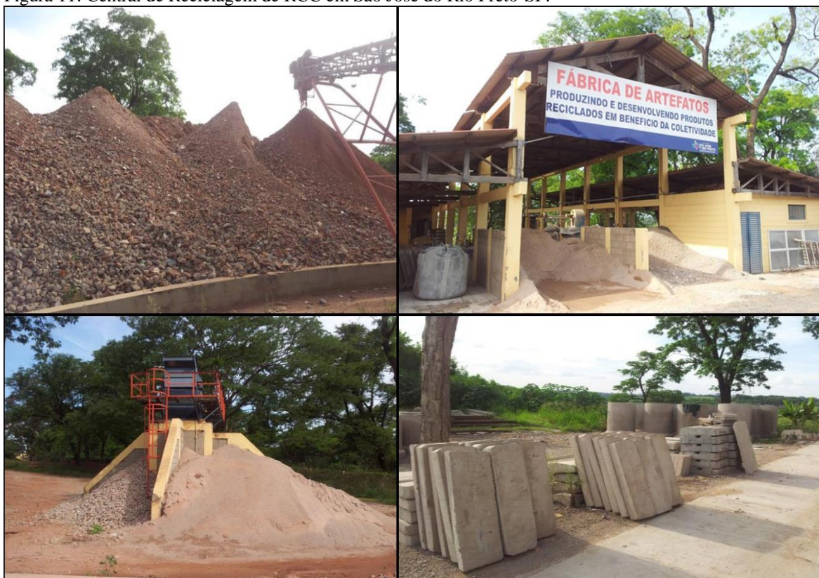
Figura 11: Central de Reciclagem de RCC em São José do Rio Preto-SP.
